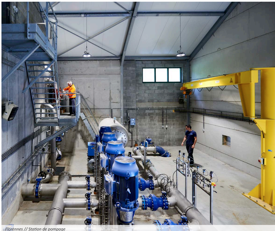
Floréennes // Station de pompage
