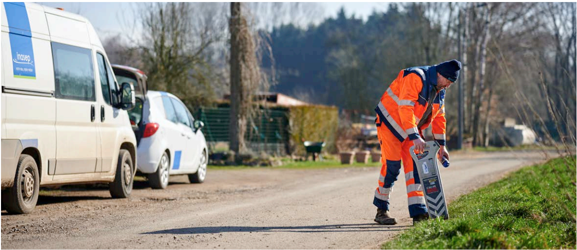
Recherche de fuite
